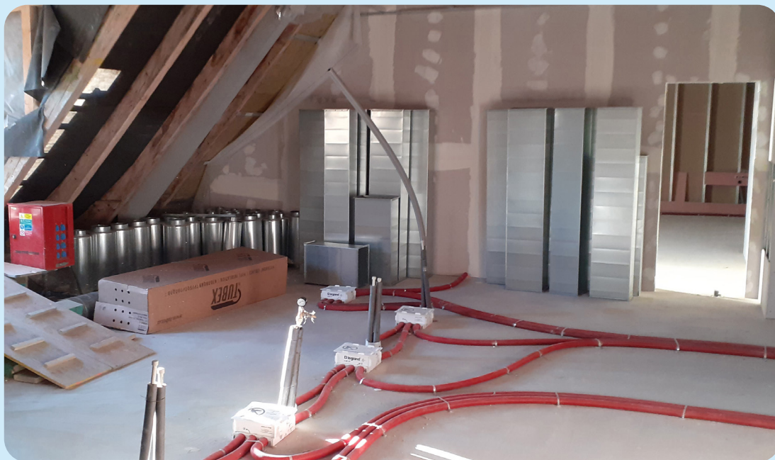
Probíhající půdní vestavba budovy Bubeneč č. p. 930 (ZŠ a MŠ Emy Destiniové a ZŠ a MŠ náměstí Svobody 2)
